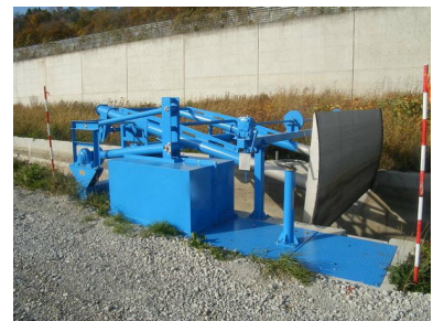
写真-20.2 水位調整ゲート(2)
