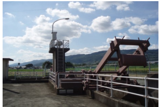
写真-20.1 水位調整ゲート(1)
