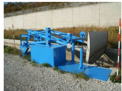
写真-20.2 水位調整ゲート(2)
