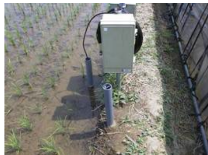
写真-6.10 水位センサー式水位計設置例2
