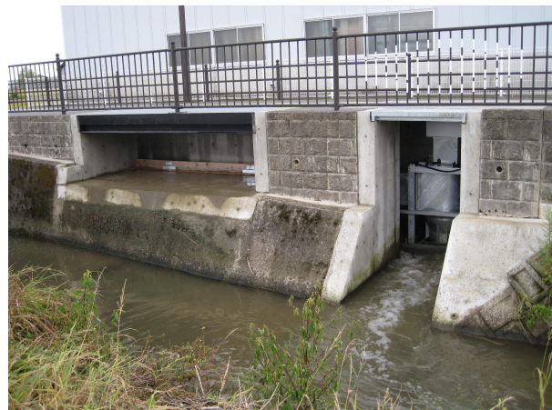
写真-22.2 導水路の余水吐 (左) と放水口発電機 (右)
