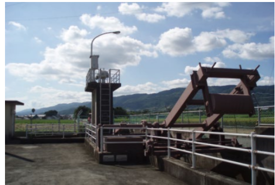
写真-20.1 水位調整ゲート(1)
