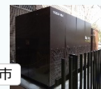
あづま総合運動公園 100kW燃料電池
