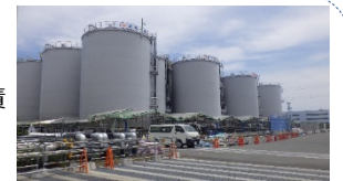
ALPS処理水保管タンク（測定・確認用設備）
