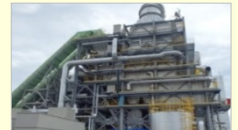
仮設焼却施設
