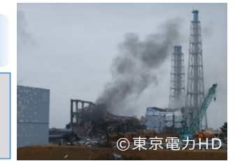
水素爆発を起こした直後の3号機
