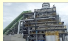
仮設焼却施設
