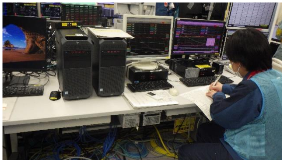
(写真1-1) 3号機PCVパラメータ確認状況① (免震重要棟集中監視室内)
