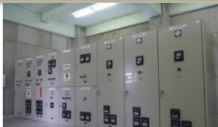
高圧受電設備、送水ポンプ盤
