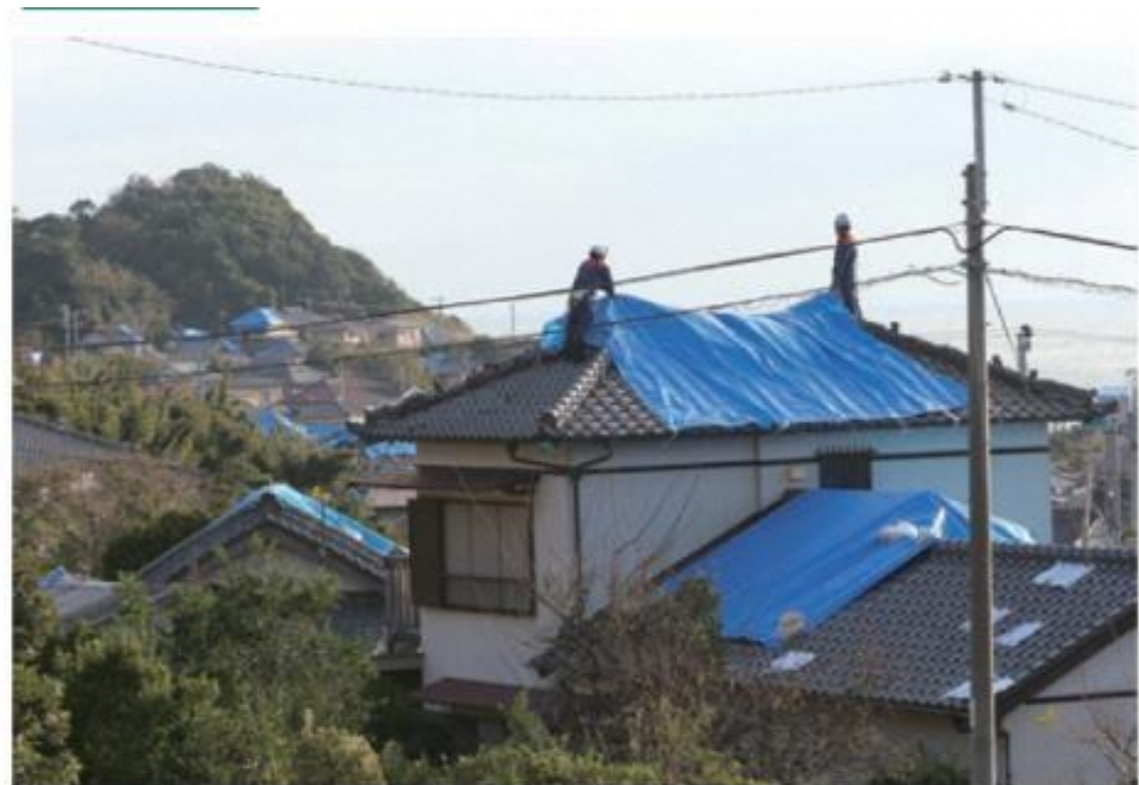
令和元年房総半島台風の被害の様子
