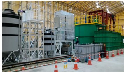
洗浄工程設備
