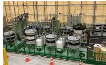
吸着工程設備 (3設備のうちの1設備)
