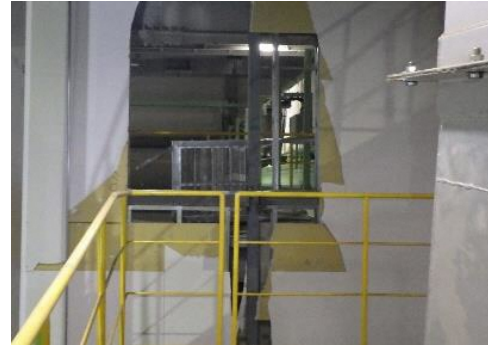
仮設灰処理 灰ピット～前処理区 画内壁損傷
