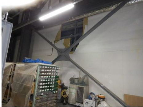
仮設灰処理 内壁脱落
