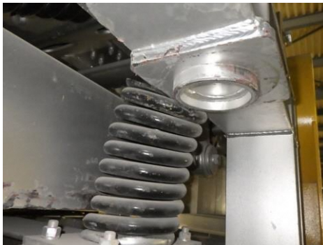
仮設灰処理 生成物コンベアの損傷
