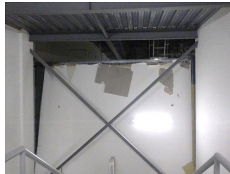
仮設灰処理施設内壁落下
