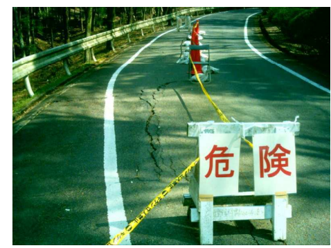
管理道路崩壊状況
