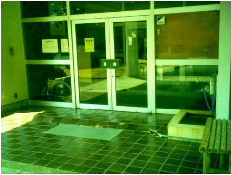
本館被災状況 本館玄関前陥没・ガラス破損
