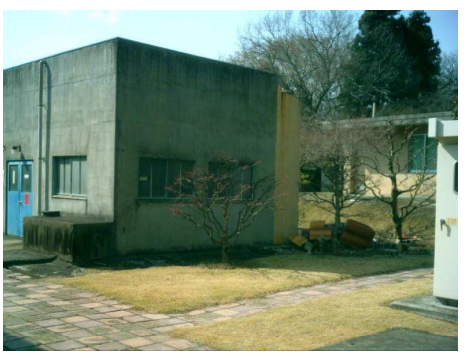
ボイラー室煙突倒壊状況
