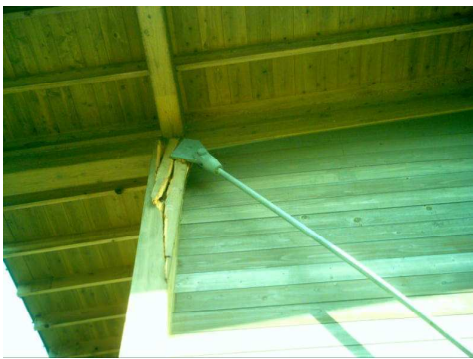
木材加工棟被災状況
