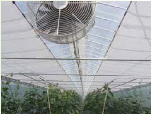
遮熱対策 (循環扇・遮光ネット・ミスト)
