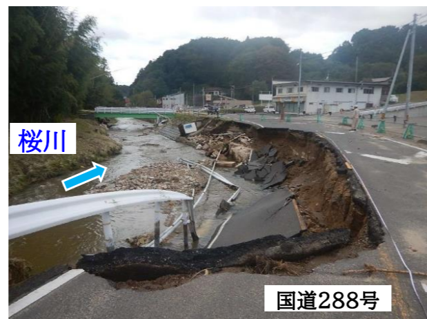
令和元年10月 東日本台風被害状況(下流3工区)
