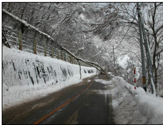
【写真①】 倒木による通行止め状況
