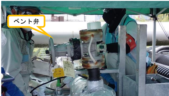
(写真1) 漏えい検知器が発報したベント弁調査の状況
