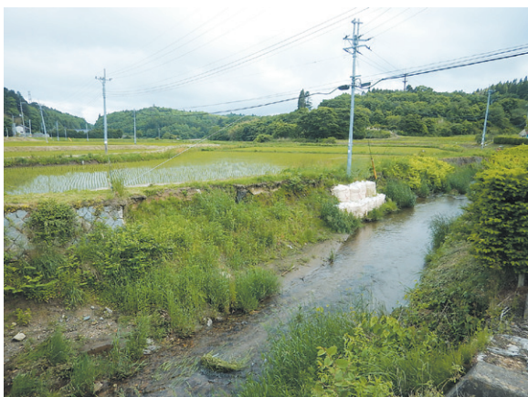
小玉川（三和町差塩）被災状況
