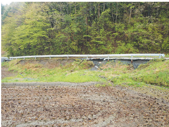
三株下市萱小川線（三和町下市萱）被災状況
