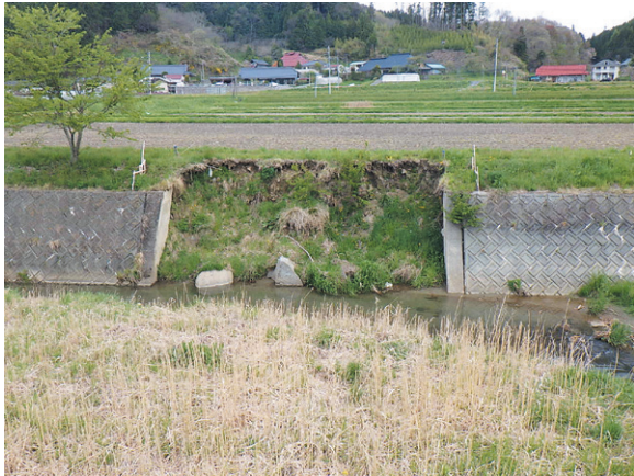
三坂川（三和町中三坂）被災状況
