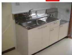
⑤台所の水栓更新(シングルバ-混合水栓付き)
