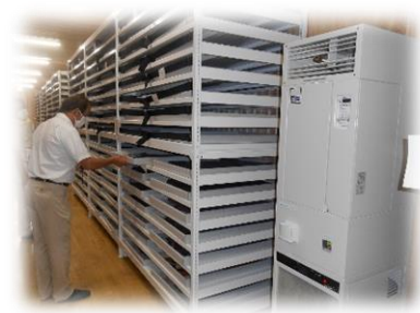
【加湿・除湿ユニットで湿度管理】
