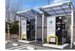
蓄電池・充電施設
