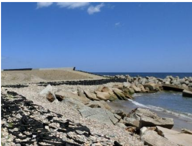
（堤防が崩れたままの海岸）
