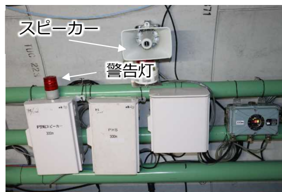
緊急時の合図設備
