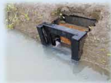
田んぼダムに取り組むため設置された排水口
