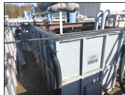
【PH調整槽外観】
