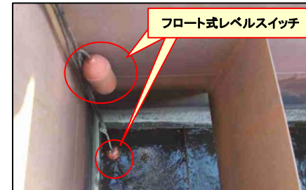
【PH調整槽内部_液位は低い状態の時】
