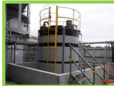
苛性ソーダ貯留槽(15m 3 )
