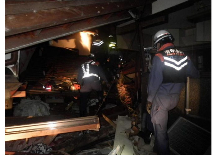
写真：有明応援隊の活動風景 倒壊建物からの救助作業 (熊本災害デジタルアーカイブより)
