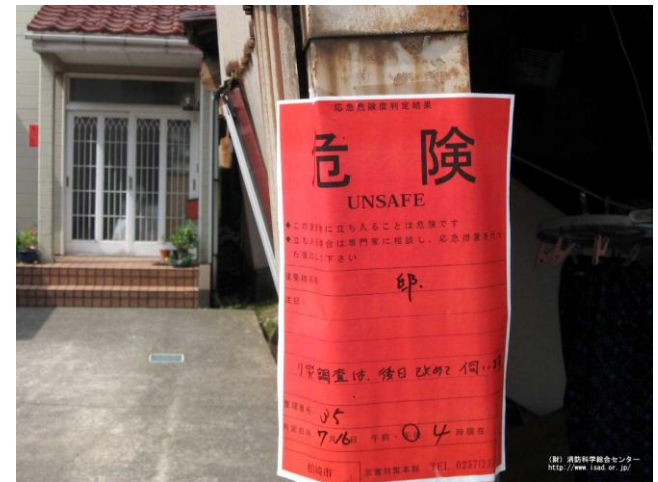
写真：平成19年（2007年）新潟県中越沖地震、 応急危険度判定結果（危険） （（一財）消防防災科学センター「災害写真データベース」より）
