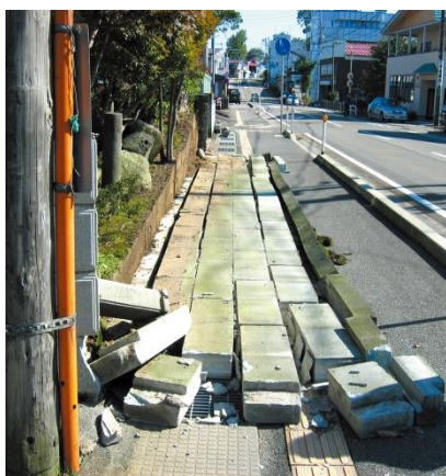
▲ブロック塀の倒壊
