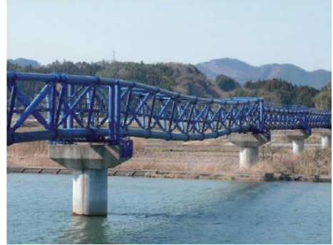
▲東日本大震災時にたわみが発生し架け替えが必要だった沼部水管橋（いわき市）
