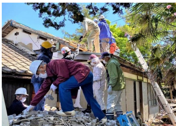
▲ ボランティア活動（壊れた屋根瓦の撤去）（桑折町） 令和 4 年 3 月 16 日福島県沖の地震
