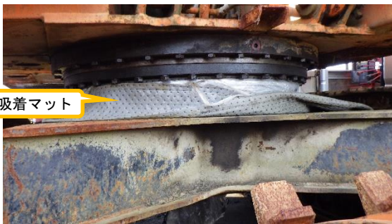
(写真5-1) バックホー②の回転軸の状況
