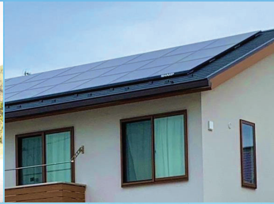
自家消費型 太陽光発電設備の普及拡大
