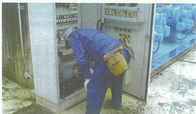
馬越ゲート機側盤点検
