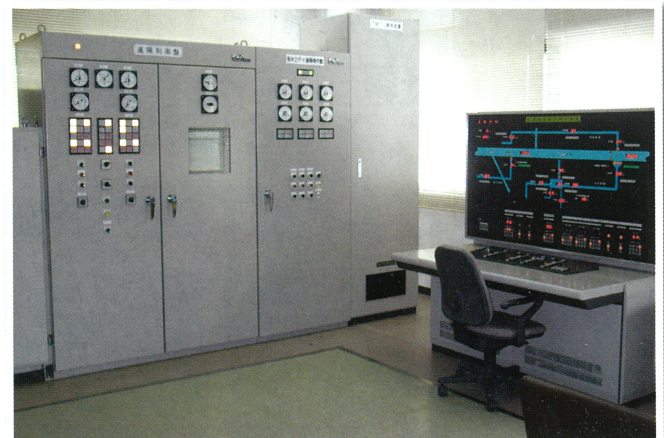
管理事務所(水管理システム)
