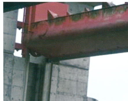
とみかわ 富川頭首工ゲート設備
