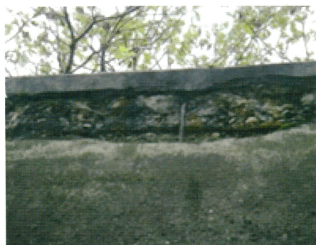
コンクリートのはがれ(開水路)
