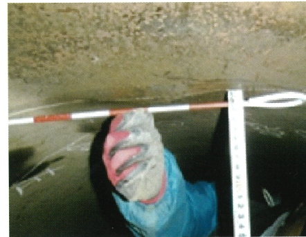
変形している(管水路)
