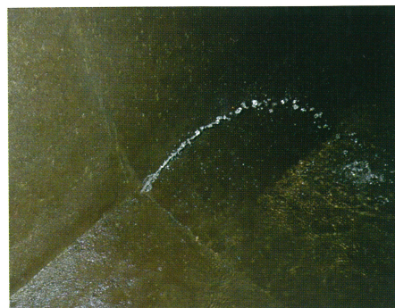
水がもれている(トンネル)
