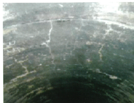
水路内のひび割れ(管水路)
