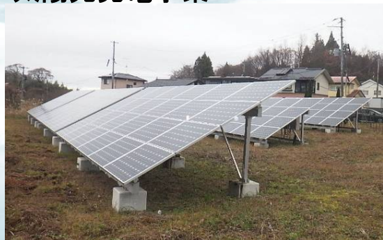
写真：太陽光発電所
