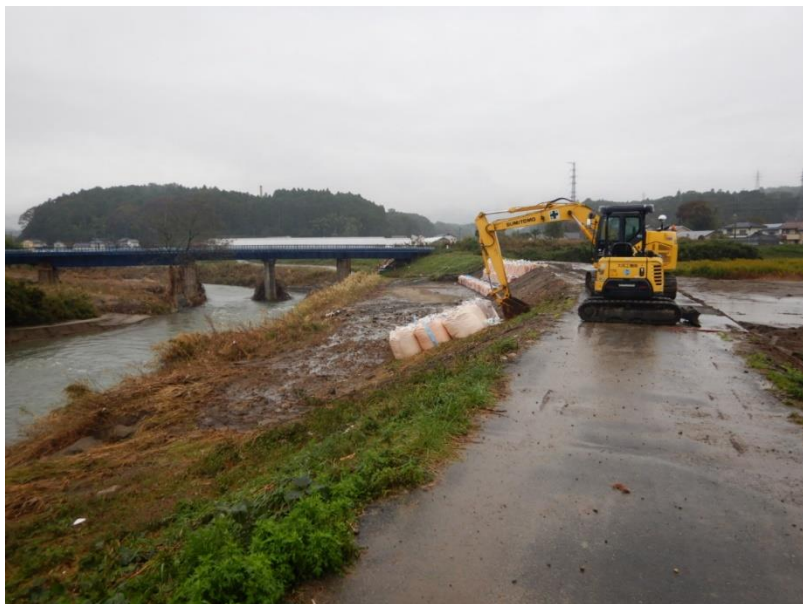
好間川大雨決壊箇所の様子 2019年10月29日福島地方気象台職員撮影
