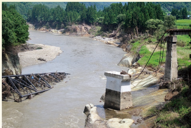
流失した第七只見川橋梁
