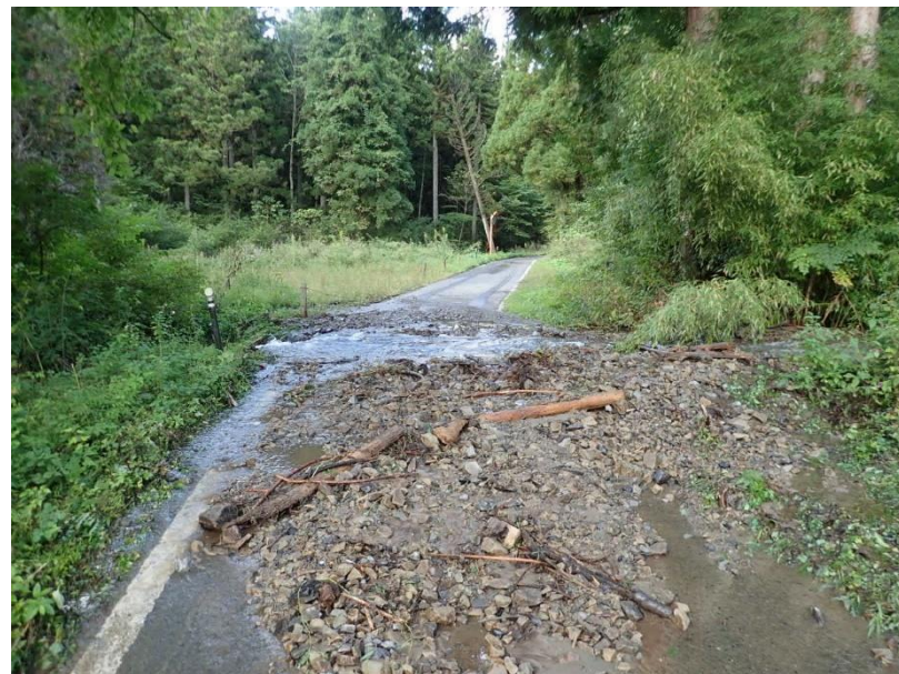
八溝山線 (棚倉町大梅地内)
