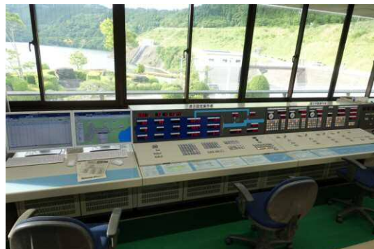
四時ダムの操作室
