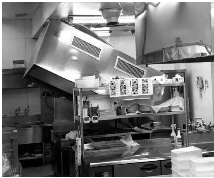
セデッテかしま厨房(南相馬市)
