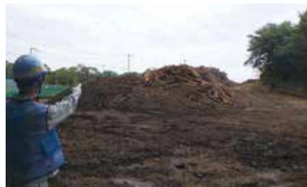
増設焼却炉で減容処理される敷地内の伐採木
