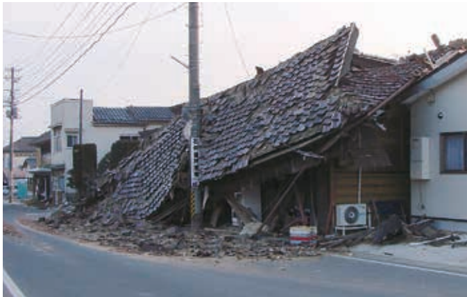
地震で被災した旧耐震基準の木造住宅
