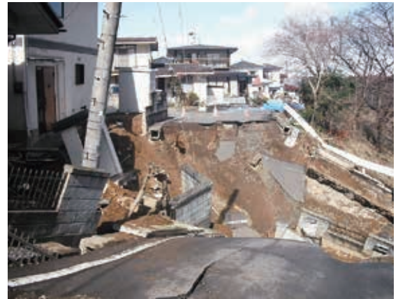
土砂崩れによる被災状況
