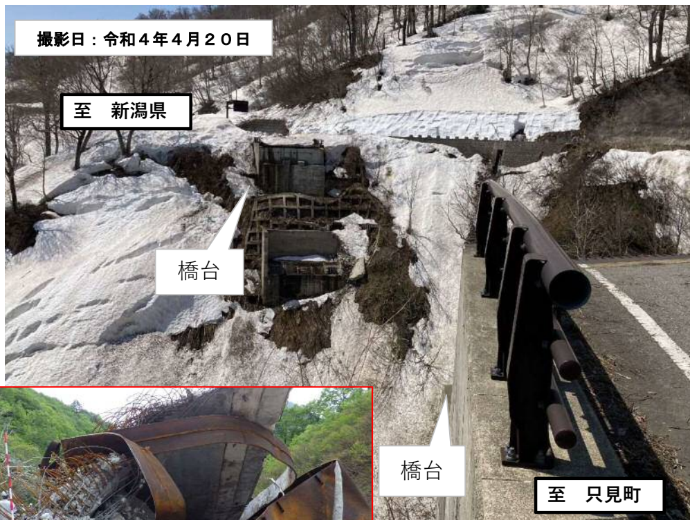
～あいよし橋の流失後の写真～
