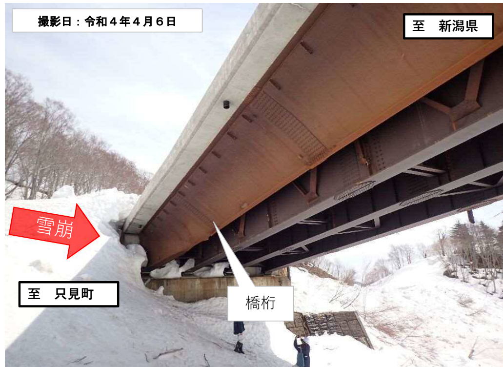
～出逢橋の損傷後の写真～
