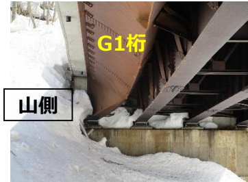
写真2：G1桁変状（拡大）
