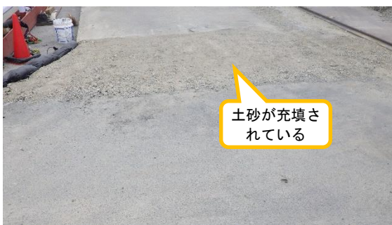
(写真2-1) 5号機南側斜路 地割れ発生箇所① (東側から撮影)
