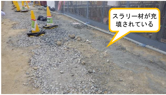
(写真1-1) 5・6号機敷地護岸ヤード 地割れ発生箇所① (北東側から撮影)
