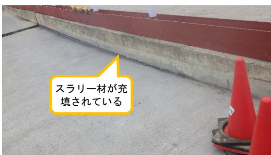
(写真2-2) 5号機南側斜路 地割れ発生箇所② (南東側から撮影)
