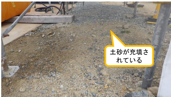
(写真1-2) 5・6号機敷地護岸ヤード 地割れ発生箇所② (南東側から撮影)
