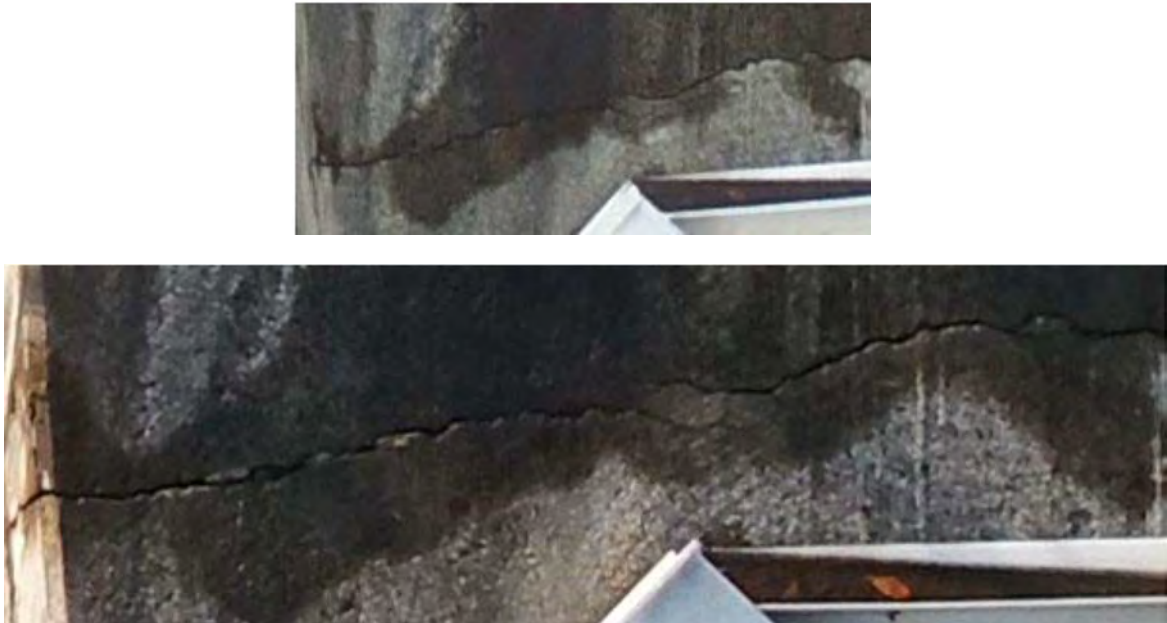
図-4.11.15 人見谷ブロックコンクリートひび割れ状況写真 (上：近接撮影1200万画素等倍表示 下：2080万画素等倍表示)
