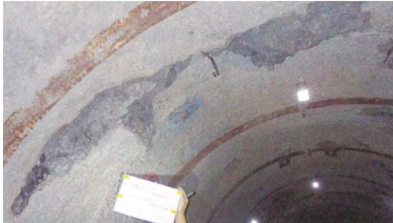
図-4.11.5 トンネル覆工部の変状
