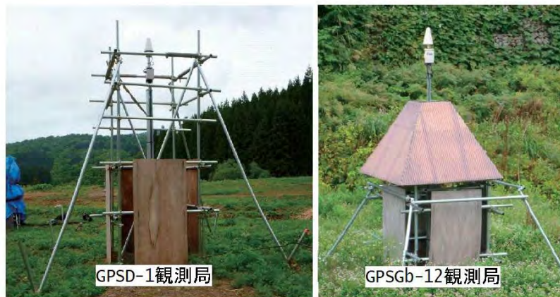
図-4.8.2 豪雪地域におけるGNSS観測局の設置例（庄内あさひ地区（山形県））
