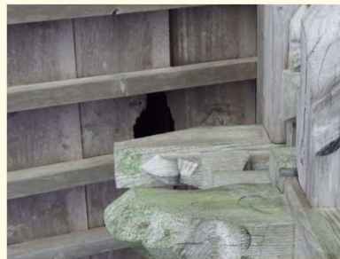
アライグマが侵入していた屋根裏の穴
