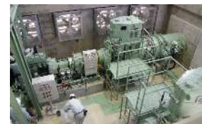
排水機場内部
