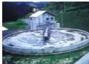
畜産環境対策施設
