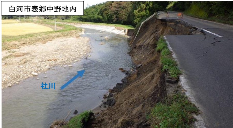
【被災状況（令和元年月10月17日撮影）】
