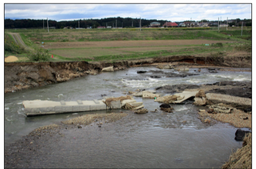
▲須賀川市仁井田大堰地区 被災状況(R元.10月)
