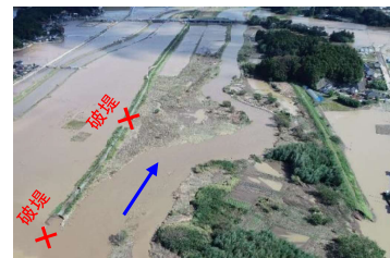
宇多川(相馬市) 【東日本台風による被災状況】
