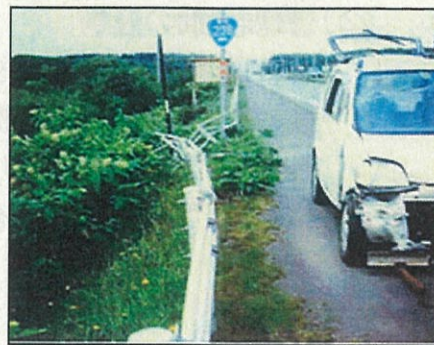
◆事故により破損した防護柵
