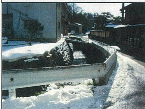
ガードレール
