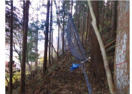
高エネルギー吸収型 落石防止柵工
